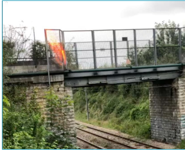
Figure n° 28 : Fuite enflammée sur la traversée aérienne de Saint-Ouen-L'Aumône (95) le 14/07/2021
